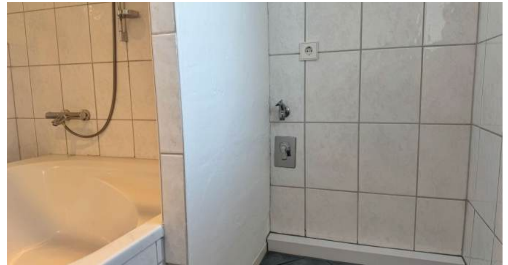
Waschmaschinenanschluss im Badezimmer
